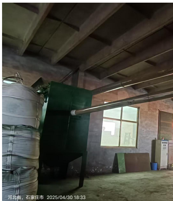
3#焙烧炉废气处理设施布袋除尘器 2
