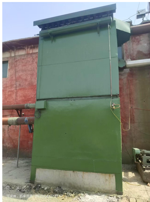
1#焙烧炉和 2#焙烧炉废气处理设施布袋除尘器 1
