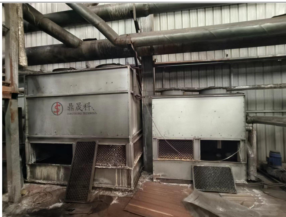
内壁循环冷却器
