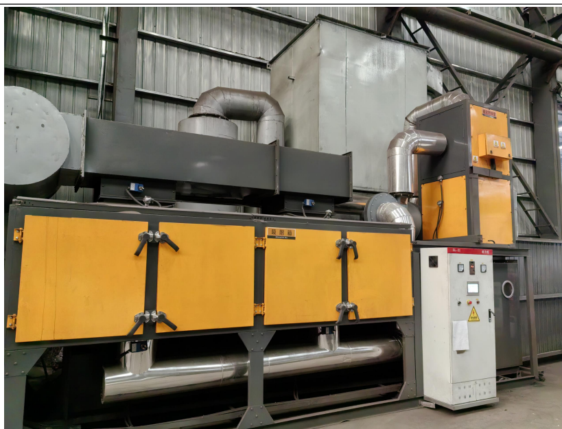
袋式除尘器 C+活性炭吸附/脱附（催化燃烧）设施
