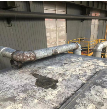
DA081 采样平台、采样孔
