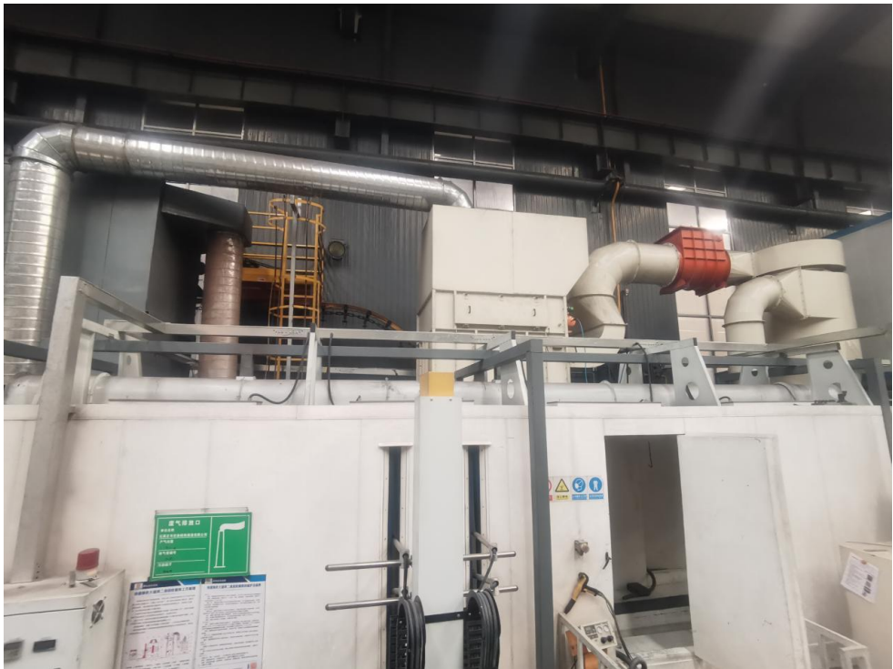
喷粉废气（一级大旋风+二级滤芯回收+袋式除尘器 F）
