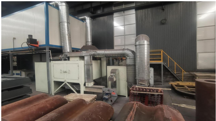
固化废气活性炭吸附/脱附（催化燃烧）
