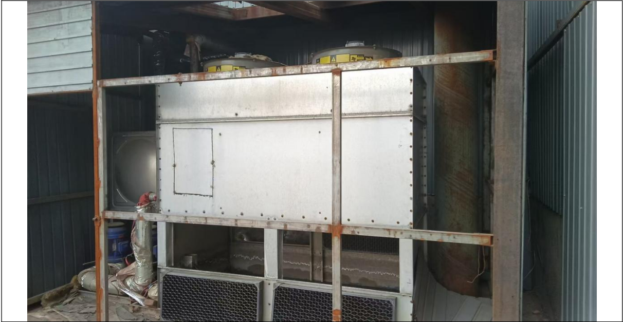
内壁循环冷却器
