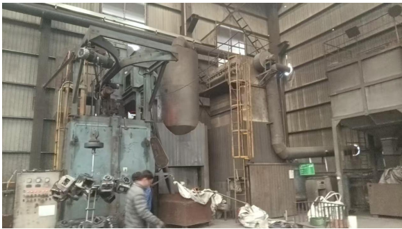
粗抛丸废气布袋除尘器 C
